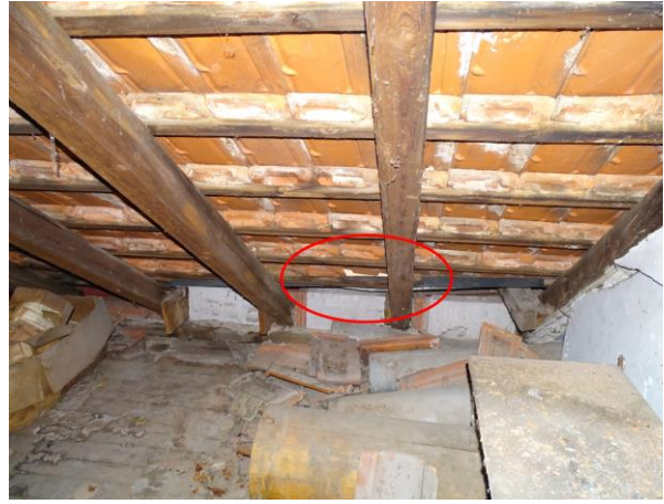
Abb. 14: Schadstelle in der Dachhaut
