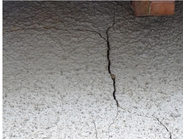
Abb. 19: Riss an der westlichen Außenfassade
