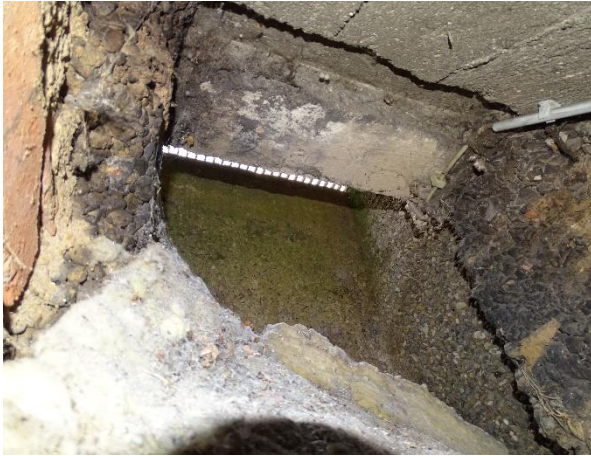
Abb. 7: Belüftungsschacht in kleinem Geräteraum
