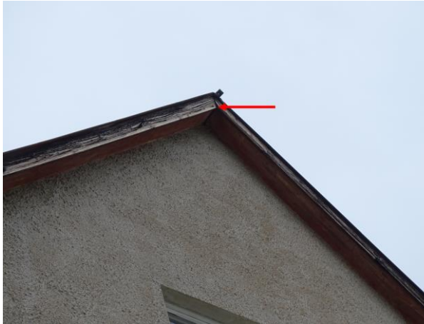
Abb. 18: Spalt zwischen den beiden Ortsgängen an der Südseite (roter Pfeil)
