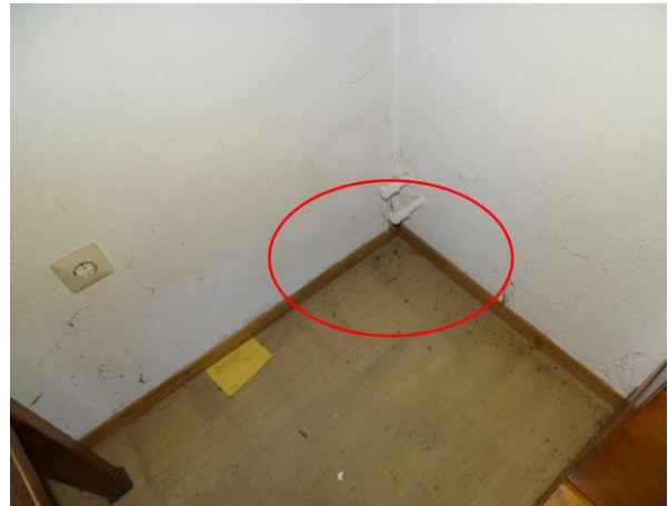
Abb. 12: Mäusekot in Büroräumen
